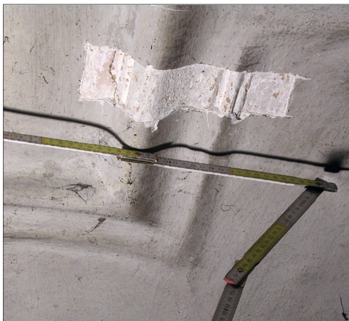
Obr. 87: Správné zaměření není u plastických architektonických prvků překrytých silným souvrstvím nátěrů leckdy vůbec možné. Polohové i tvarové rozdíly se zde mohou pohybovat v řádu centimetrů. Správné zaměření umožní pouze přímé zpřístupnění a sondáž (Kněževes – okres Rakovník, hostinec čp. 102, štukové zrcadlo stropu v proním patře; foto J. Veselý, 2012).
